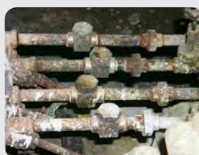
Purgadores de vapor
